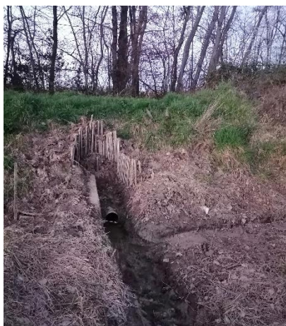
Clapet de riverain entretenu (vue côté terre)
